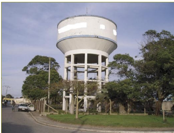
Figura 6 - Caixa d'água do abastecimento público
